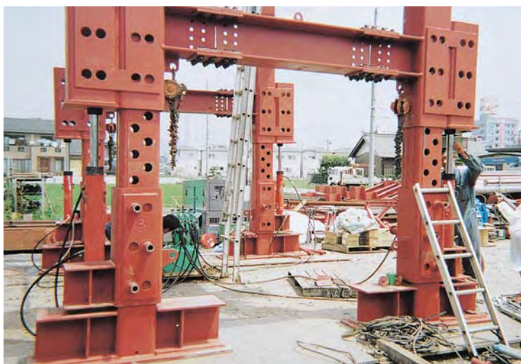
柱のジャッキアップ用 (500kN油圧ジャッキ&4連分流利器付電動ポンプを使用)
